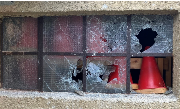
Rozbité okno v areáli MŠ a ZŠ na budove oproti hlavného vchodu do budovy.
