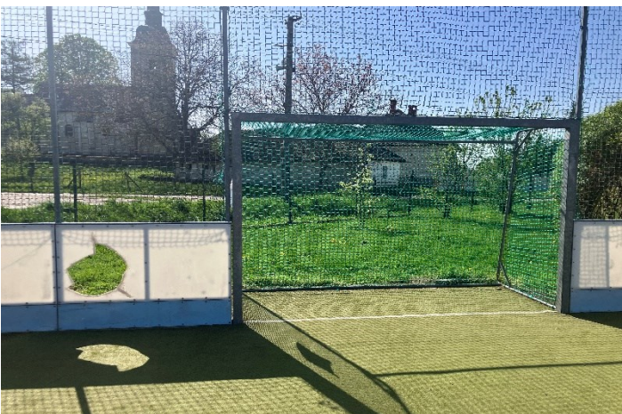
Rozbitý mantinel na multifunkčnom ihrisku.
